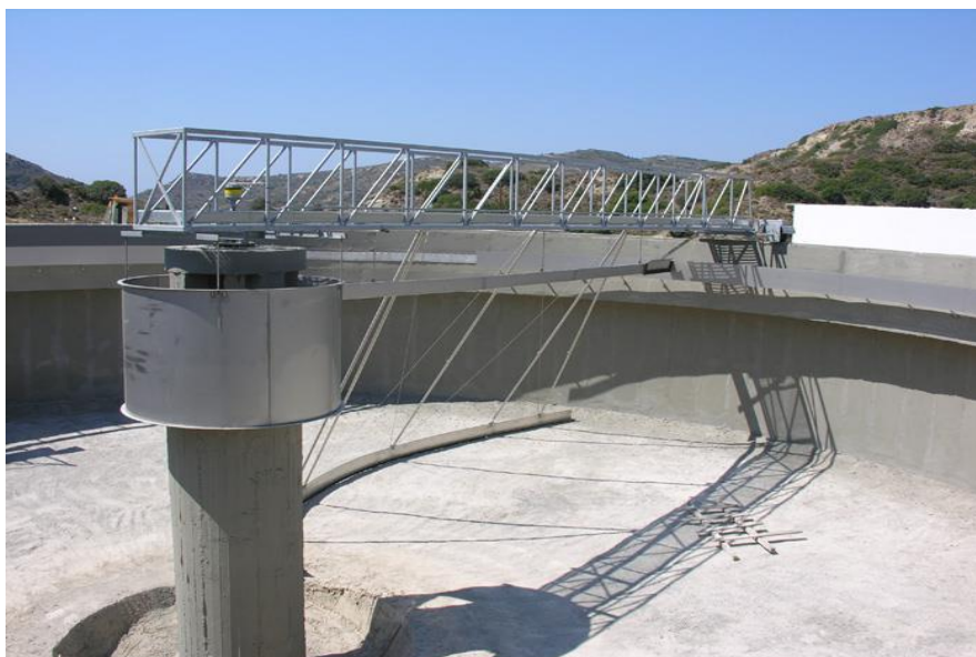
Εικόνα 8: Δεξαμενή 1 η β βάρθμιας καθίζησης με κινητή γέφυρα
