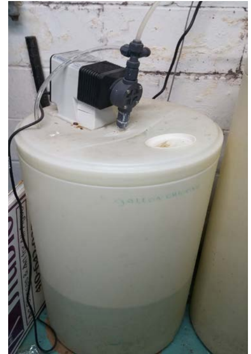
Σύστημα δοσομέτρησης υποχλωριώδους νατρίου
