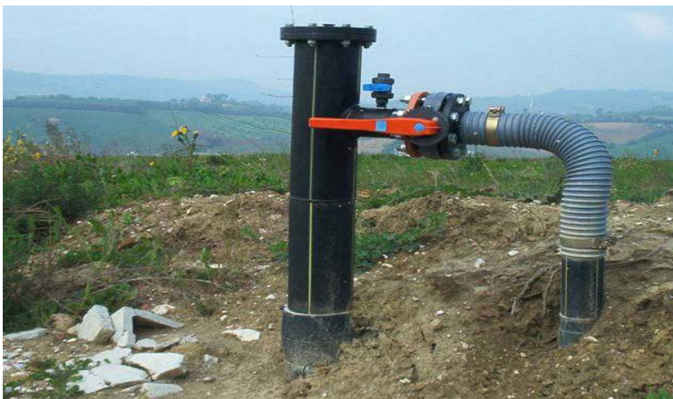
Εικόνα 6.3: Η κεφαλή του φρεατίου άντλησης βιοαερίου σε έναν ΧΥΤ [Cossu, 2010].
