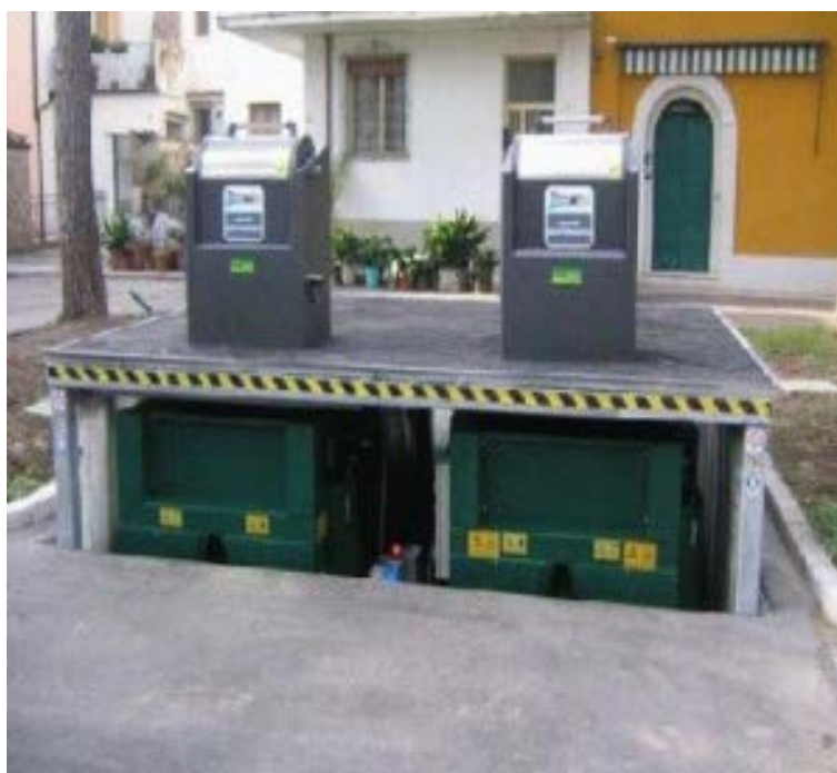
Εικόνα 2.6: Παραδείγματα υπόγειων ανερχόμενων κάδων απορριμμάτων.
