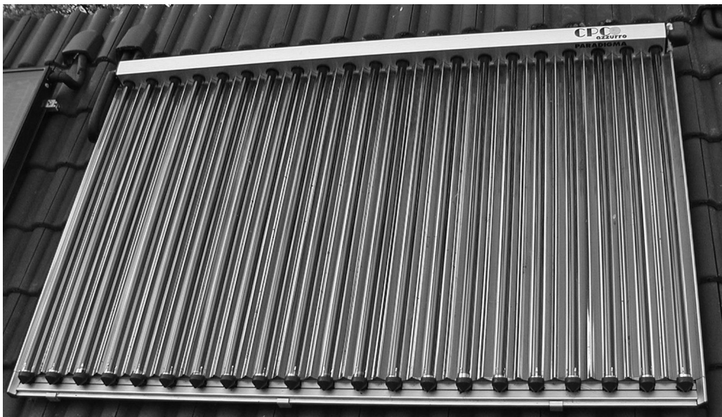
Εικόνα 3.2 Ηλιακός συλλέκτης κενού εγκατεστημένος στη νότια πλευρά στέγης σε κατοικία στη Γερμανία.
