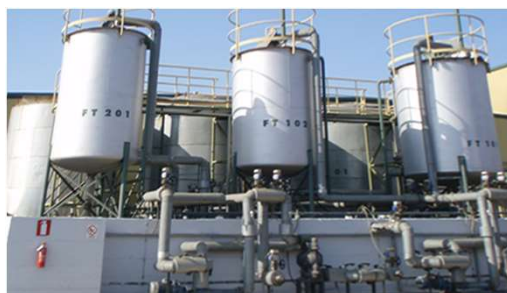
Βιομηχανική μονάδα επεξεργασίας υγρών αποβλήτων
